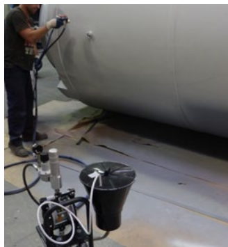
Depósito de gravedad
